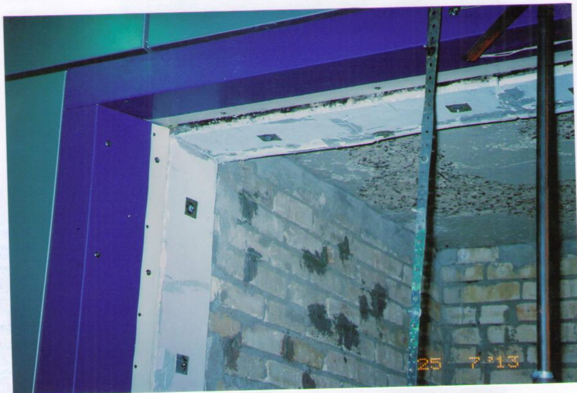
Рис.5.2. Укрупненный вид перед испытаниями выполненной из «Alcotek FR Plus» накладной панели облицовки на верхнем откосе и накладной кассеты облицовки из «Alcotek FR Plus» на боковом откосе оконного (огневого) проема образца фасадной системы.
