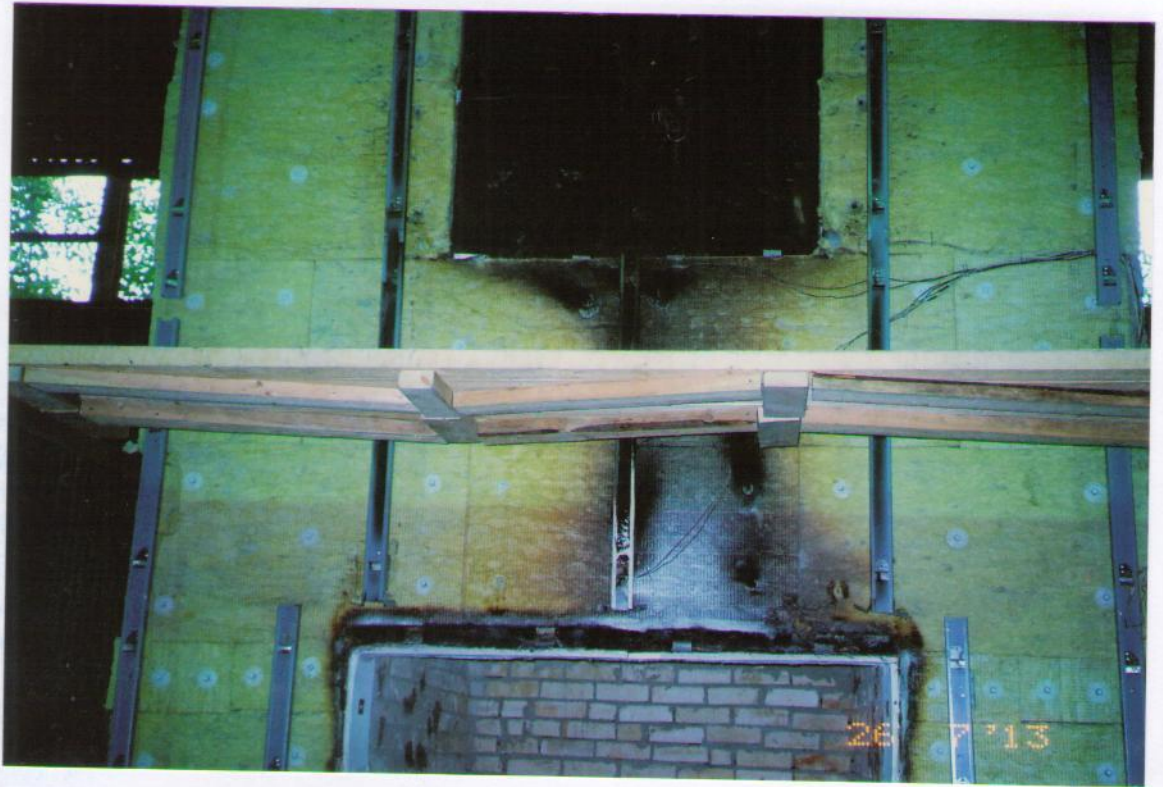
Рис.5.24. Состояние после испытания «подконструкций» и минераловатных плит утеплителя в простенке образца фасадной системы между верхним откосом оконного (огневого) проема и нижним откосом имитации оконного проема. [См. совместно с рис.5.22].
